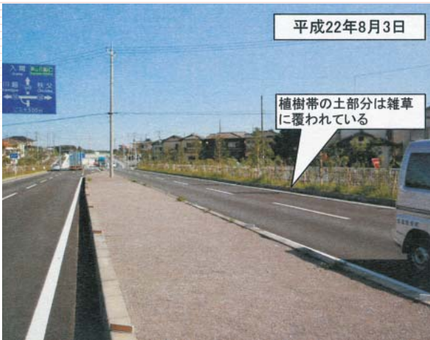
平成22年8月3日 雑草がほとんど発生していないアークサンドが施工された中央分離帯
